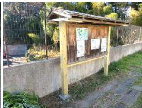
城址口の支柱が大分痛んで倒れそうな状況で、屋根を降ろして支柱を交換作業、頑張った交換作業。
