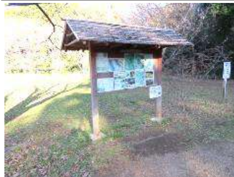
芝生広場の掲示板は脚のひび割れと柱の腐れのため、補修をどのようにするかを検討
