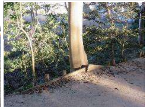
上と同様に板が外れて危険: 西原に修理指示
